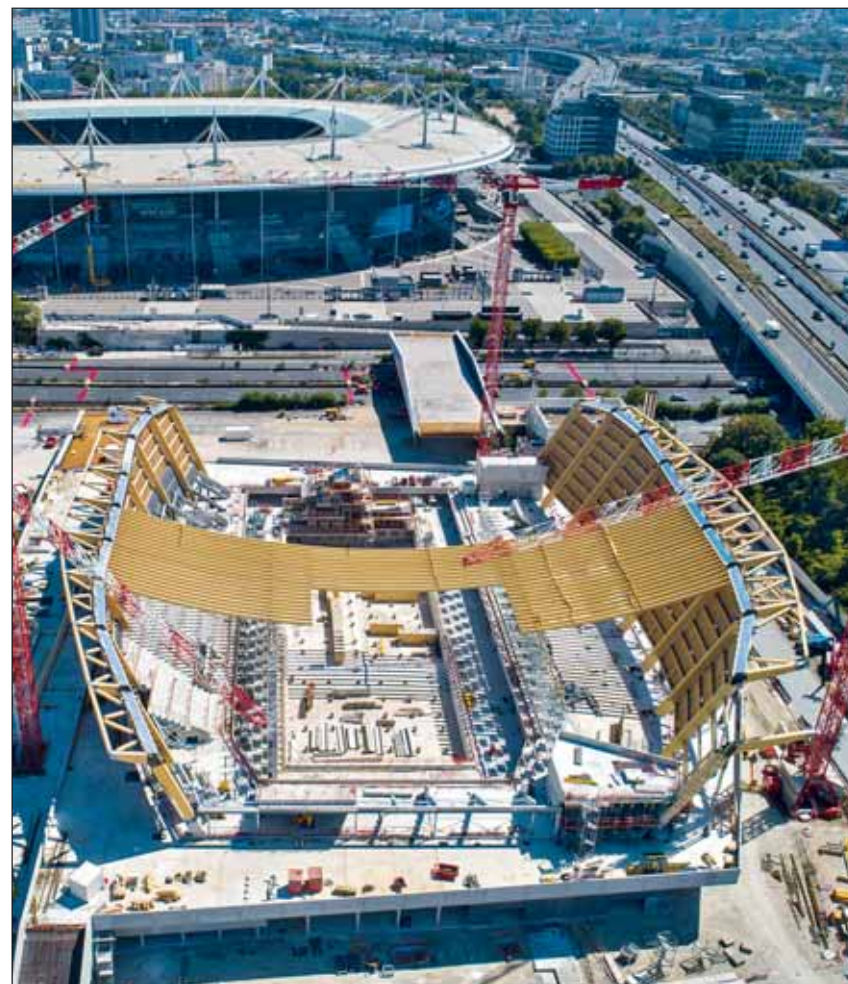
Das Centre Aquatique Olympique im Aufbau – Blickrichtung Osten (Architecture Venhoeven CS & Ateliers 234). Fotos: Bouygues Batiment IDF/Sylvère Koulouris (3)
